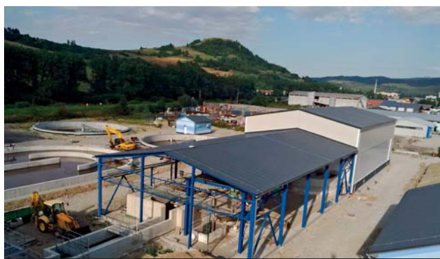
ČOV Nižná nad Oravou. Novovybudovaný objekt monobloku č. 2 a dvoch dosadzovacích nádrží. Rekonštrukcia vstupnej čerpacej stanice, haly hrubého predčistenia a budovy odvodnenia kalu.
